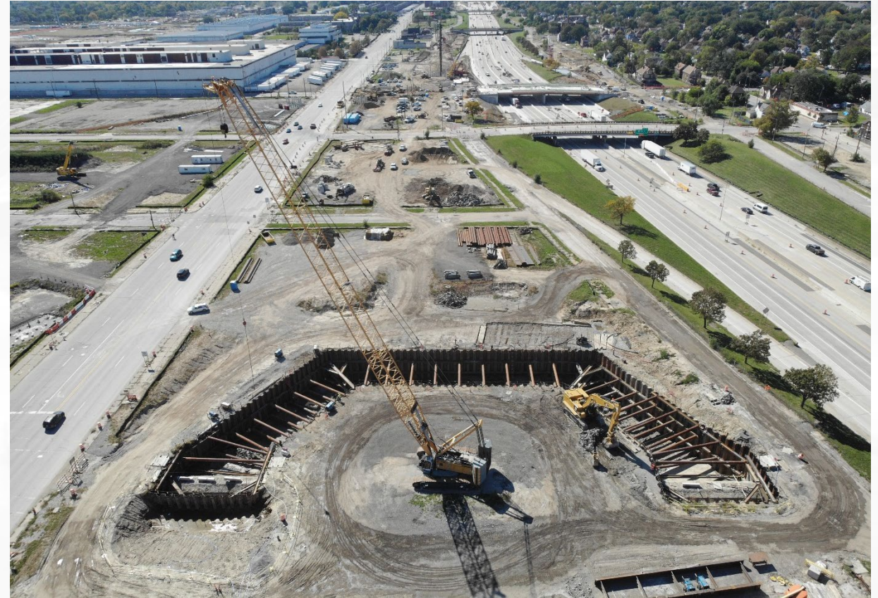
Siphons de l'I-75 sur la rue Cavalry.
